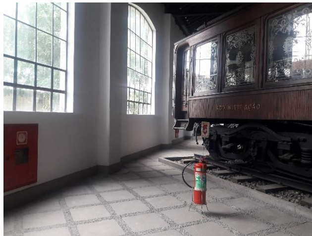
Fig.46 Área interna: Extintores.
