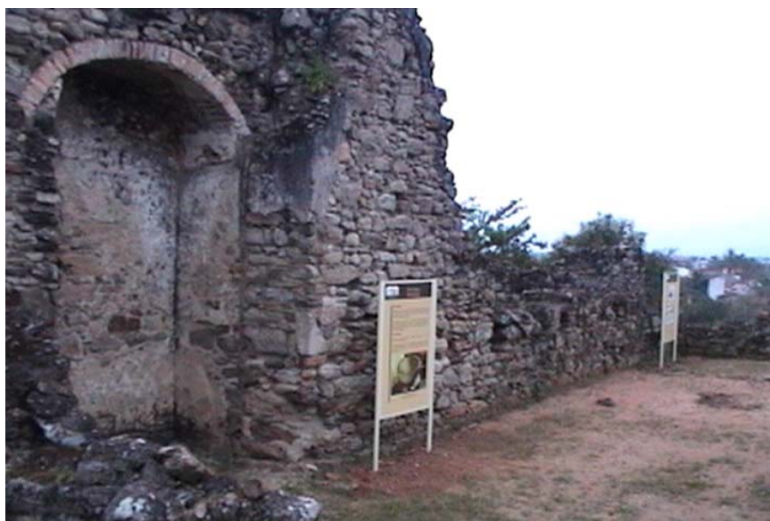
Fig. 30: Interior da ruína da igreja, nave central, tendo o baptistério à esquerda
