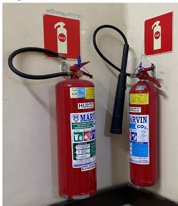
Figura 10 – Extintores de incêndio corredor
