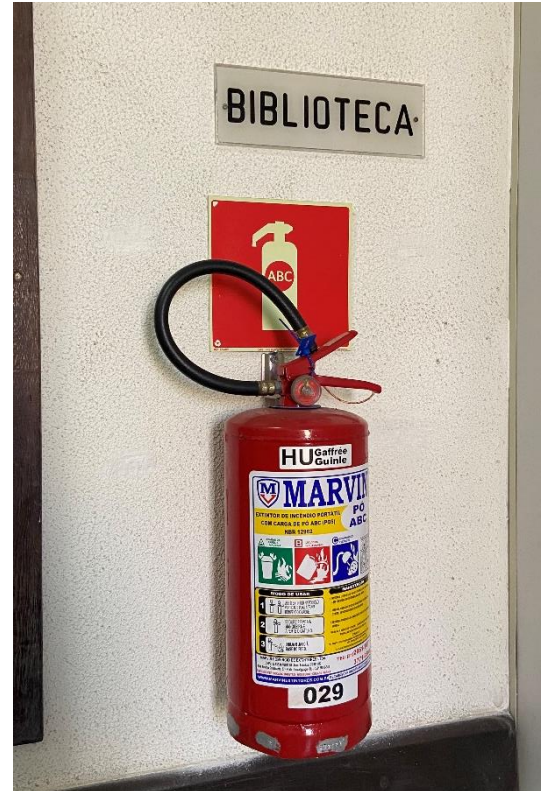
Figura 9 – Extintor de incêndio entrada
