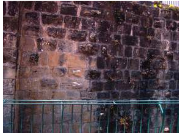
Biodeterioro de la piedra
